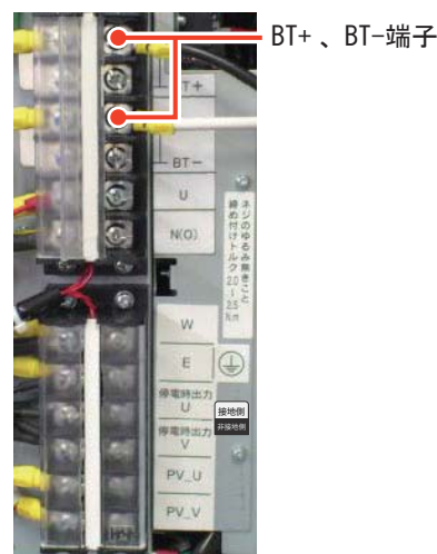
蓄電ユニット端子台
