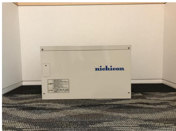
蓄電池ユニット/増設蓄電池ユニット設置状況写真
