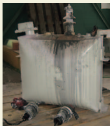
NH高圧進相コンデンサ(当社旧製品)の噴油・破壊事故品 (適切な保護がされておらず、ケース破壊に至った事例)
