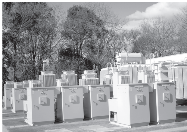
大学共同利用機関法人高エネルギー加速器研究機構様納入 交流フィルタ (6.6 kV 1 Mvar)
