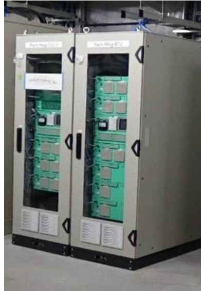
小型電磁石用直流電源（ラック内）制御ユニット 58 台、出力ユニット 221 台
