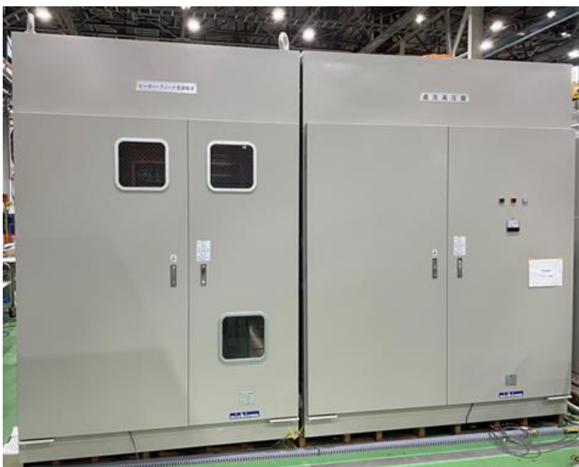
蓄積リング用クライストロン電源〈直流高圧盤〉
