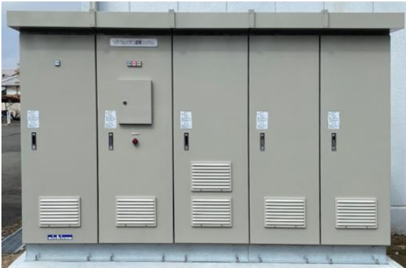
公共・産業用蓄電システム
